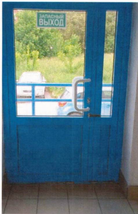
Малозаметное препятствие на пути эвакуации по ходу движения (с торца здания)
